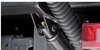
Гидравлические цилиндры с защитными трубками и пыльниками
